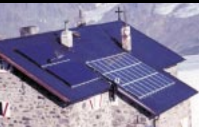
Technische Ausrüstung des Brandenburger Hauses: links die Sonnenkollektoren und rechts die Photovoltaikanlage
